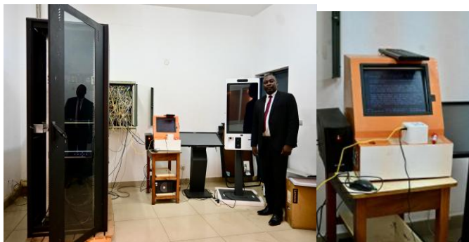
FIGURE 5 – SALLE DES SERVEURS D'ETAT CIVIL DE LA MAIRIE DE YOPOUGON, COTE D'IVOIRE
